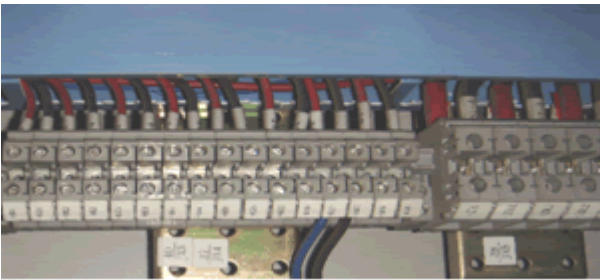
图 1-7 变频控制柜一次回路配线
